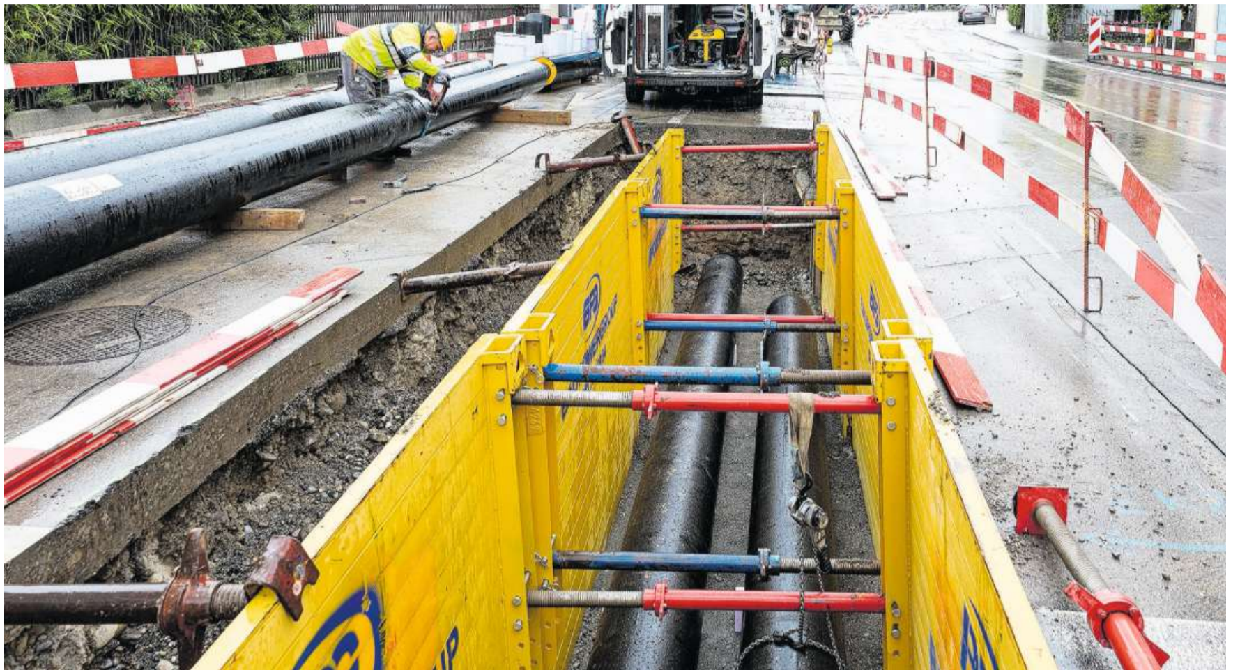
Einer der ökonomischen Hauptknackpunkte: Der Bau eines Fernwärmenetzes erfordert umfangreiche und teure Tiefbauarbeiten.
