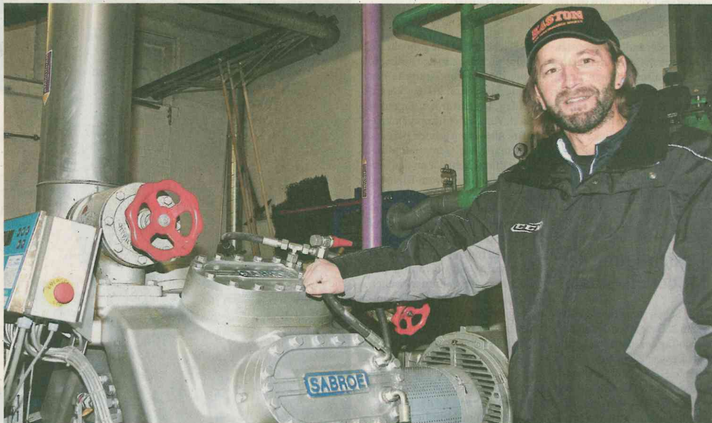
Eismeister Reto Steiner im Maschinenraum der Uzehalle: Mit dem Kompressor wird Kälte erzeugt. Ein Teil der entstehenden Abwärme wird bereits heute zur Aufbereitung von Warmwasser genutzt. Bild: Philipp Stutz
