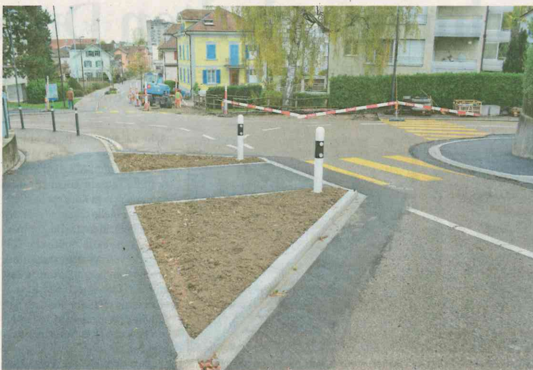
Ein Teil der Strassenverengungen an der Kreuzung Herrenhof- und Schöntalstrasse ist gemacht. Die Strassenüberquerung ist um die Hälfte kürzer. Die Fussgängerstreifen bleiben erhalten. Bilder: Urs Bänziger
