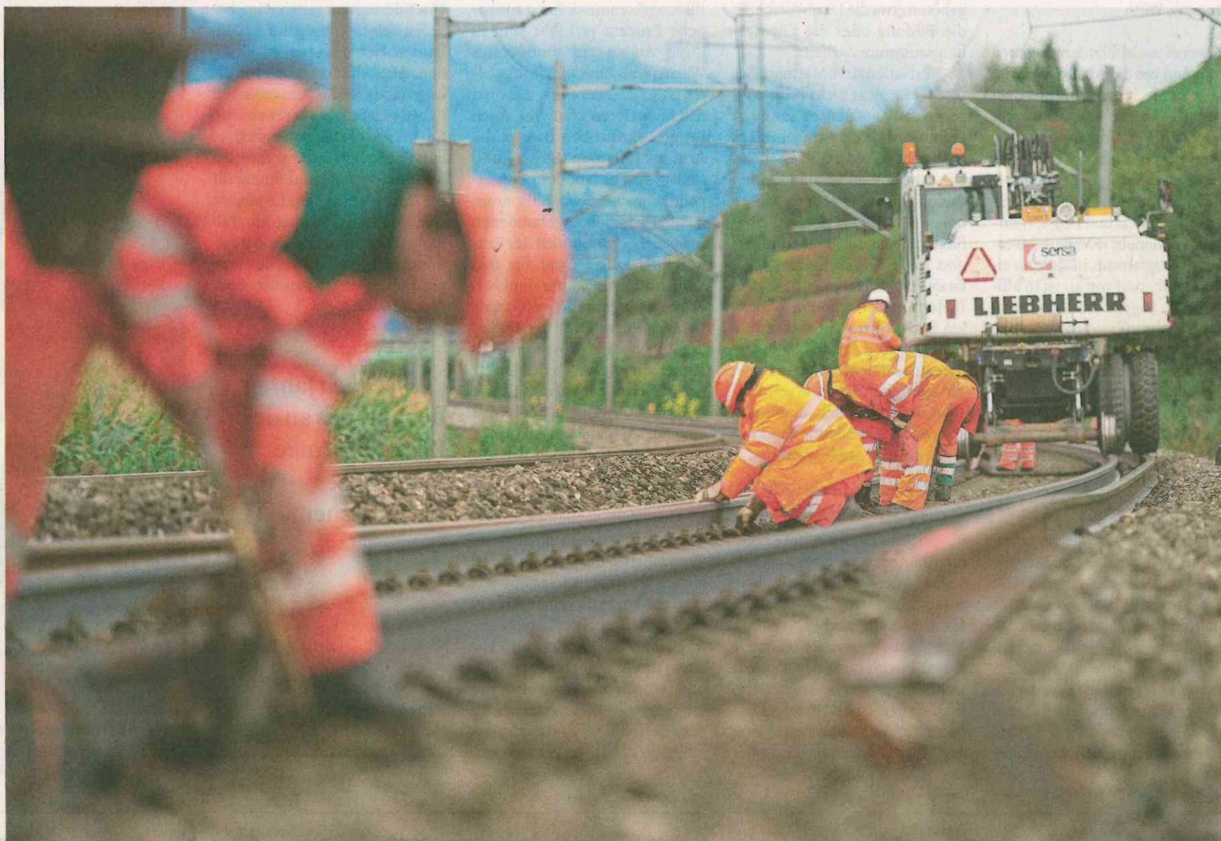
11,5 Milliarden Franken sollen in die Bahninfrastruktur investiert werden. Das Bild zeigt Unterhaltsarbeiten der SBB.
